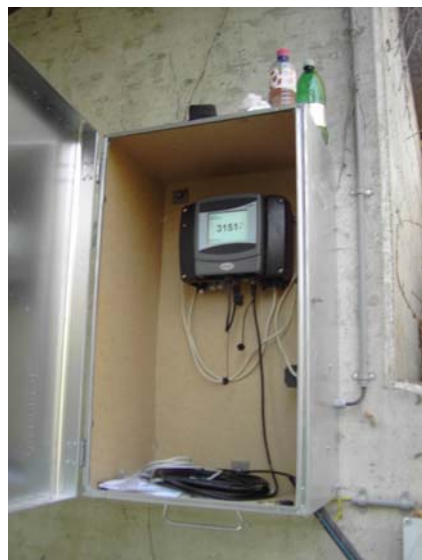
Abbildung 17: Anzeigeeinheit SC1000 in wasserdichtem Stahlkasten am linken Bröckenwiderlager montiert
