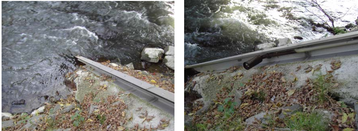
Abbildung 16: Solitax ts-line in getauchter und in „Service-Stellung“ (Sondenföhrung: Bautype „Feldbach“)
