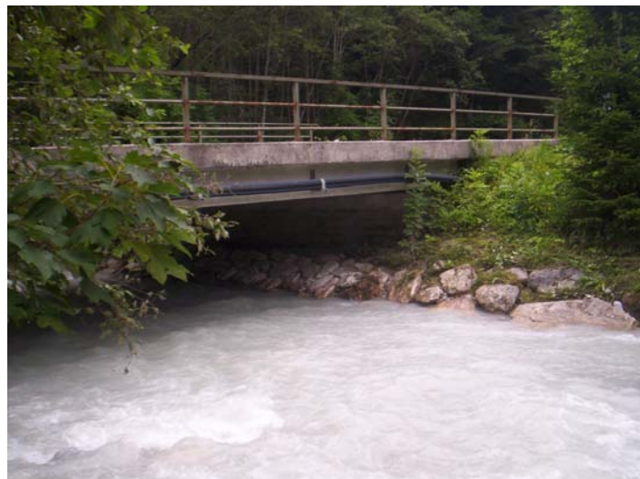
Abbildung 3: Johnsbach im Bereich der Bundesstrassenbrücke von Mündung in die Enns
