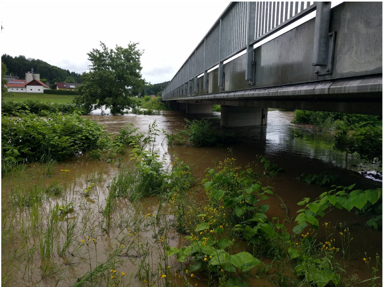
Abb. 12: Hochwasserereignis vom 15. Mai 2018 im Bereich Pegel Gündorf/Saggau
